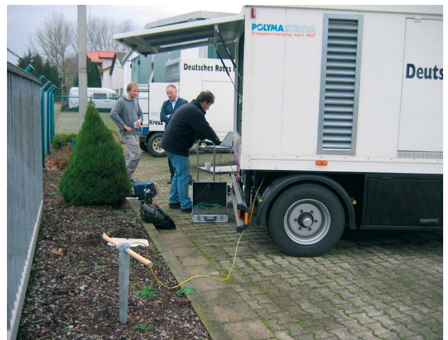
Bild 4. Ermittlung von Ableitstrom und Erdungswiderstand an einem Ersatzstromerzeuger
